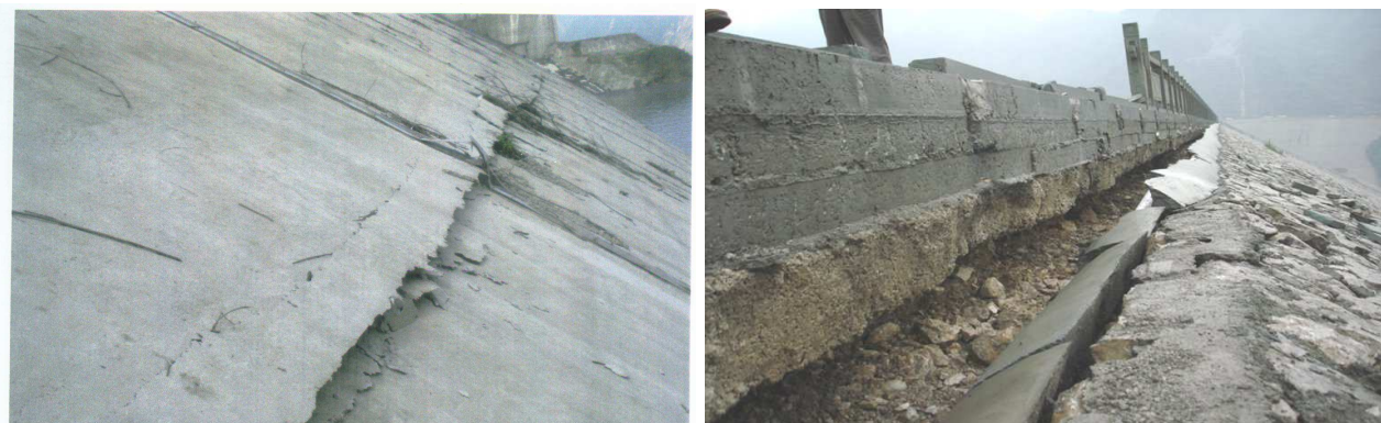
a-Ruptura Horizontal de las Losas
